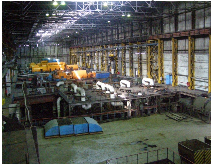
Турбинный цех ТЭЦ-2
