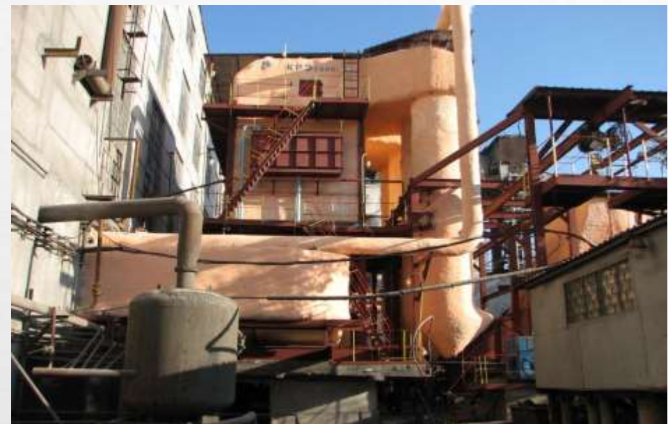
Фото эмульгатора котлоагрегата ТЭЦ-1
